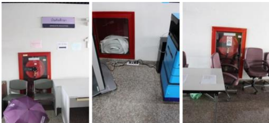
รูปที่ 2.45 บริเวณด้านหน้าตู้ฉีดยาดับเพลิงมีการนำเฟอร์นิเจอร์และสิ่งของต่างๆ มาตั้งกีดขวางการเข้าถึงเพื่อใช้งาน (แถวบนและแถวล่าง) ทำให้ไม่สามารถใช้งานได้สะดวกในกรณีเกิดเหตุฉุกเฉิน
