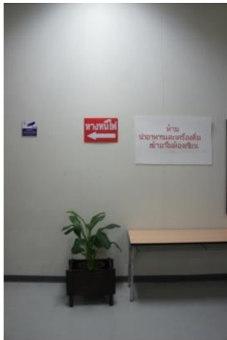
รูปที่ 2.37 เครื่องหมายและไฟป้ายบอกทางออกฉุกเฉินมีลักษณะไม่ถูกต้องตามที่กฎหมายกำหนด เนื่องจากไม่เป็นป้ายเรืองแสงและไม่มีเครื่องหมายสัญลักษณ์ตามที่กำหนด
